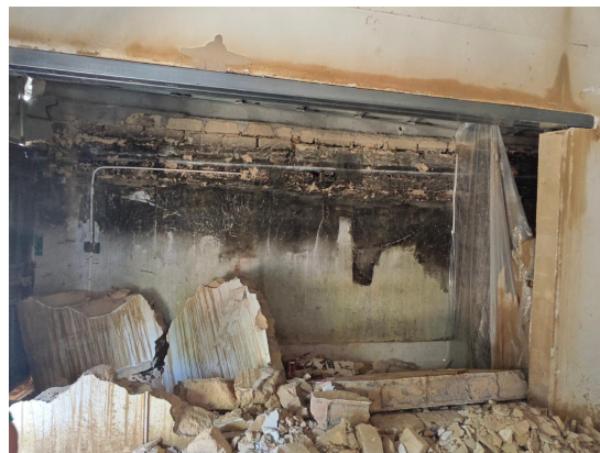
图 2：事故墙体推倒后照片
