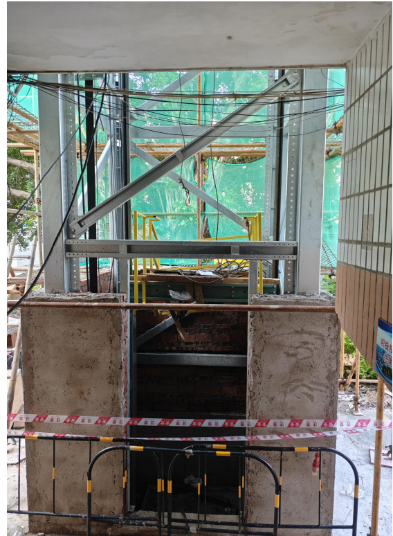
图 2 事故电梯井一层
